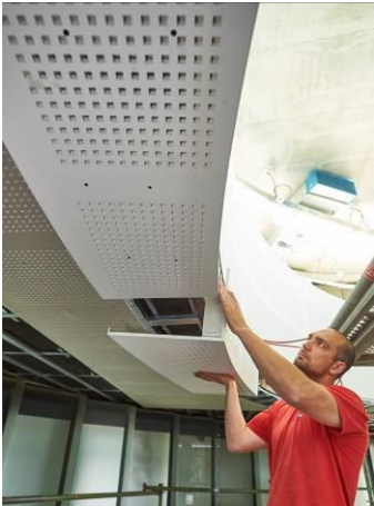
Maßarbeit. Die aus Lochplattensegmenten vorgefertigten Schürzenelemente schaffen die perfekte Rundung. (Foto: Knauf/Dirk Masbaum)
